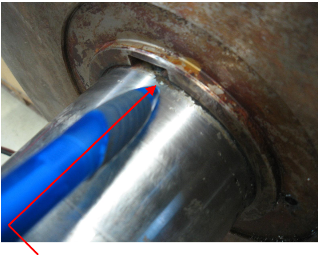
Wellenkorrosion unter den Laufrädern
